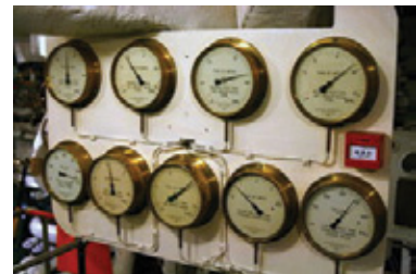
Maschinenraum eines Schiffes (Foto: Rémi Kaupp, 2007)
